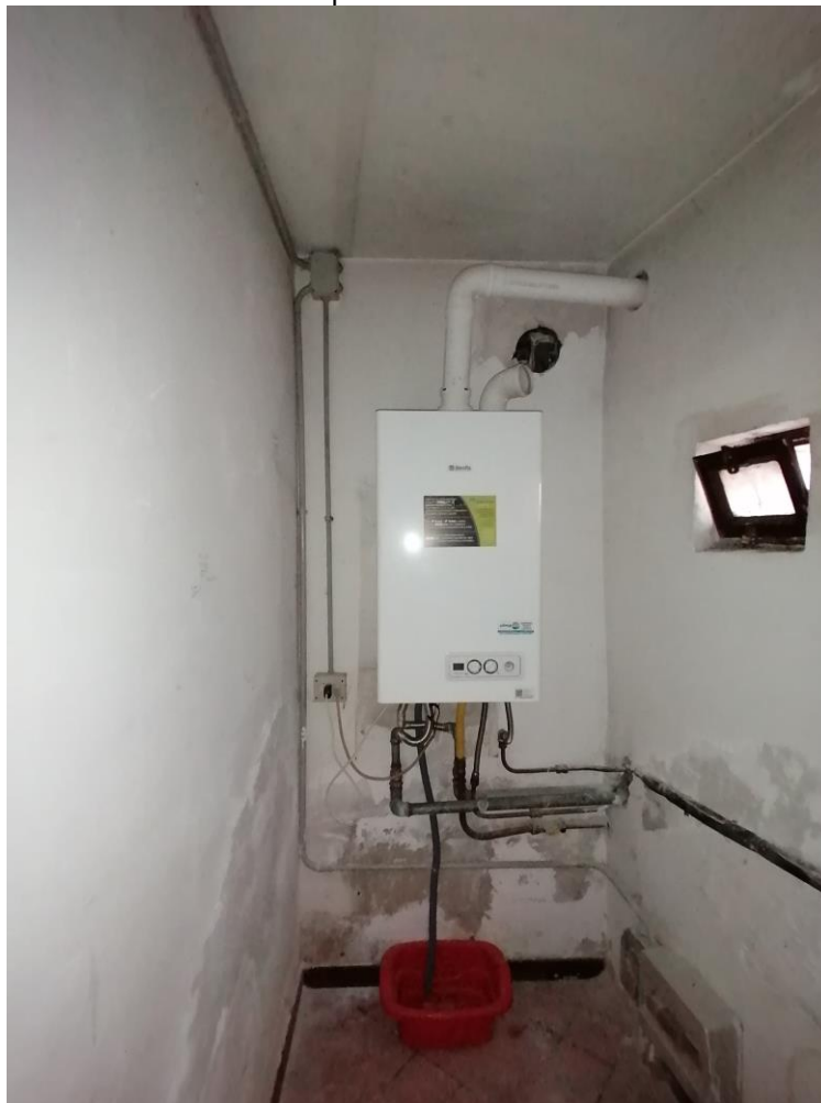
FOTO N°34: Corpo C – Centrale Termica – PT.
